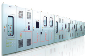
配電盤 SWITCHGEAR & CONTROLGEAR
