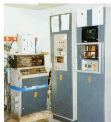
作為設備控制的配電裝置
