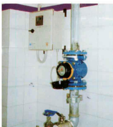
作為調節液體的控制裝置配電盤
