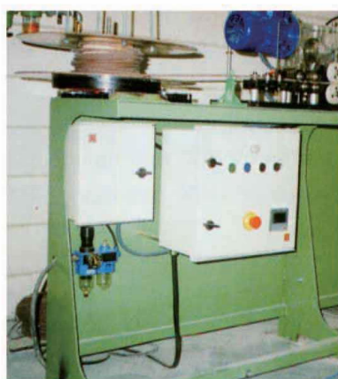
作為壓型控制裝置配電盤
